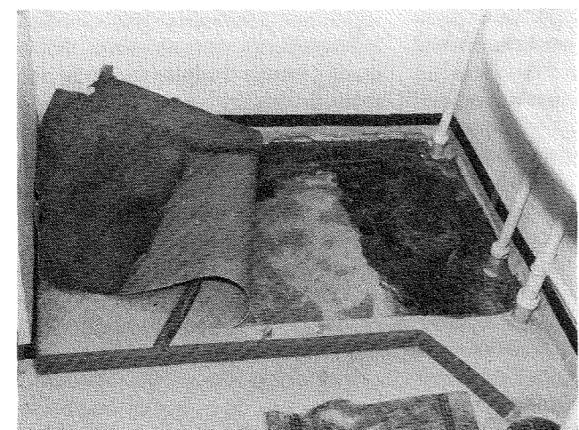
Fig. 10. Et gulv hvor vandindtrængen fra hjørnet er begyndt, men hvor vandet endnu kun har nået at fordele sig til de mørke områder på billedet.
