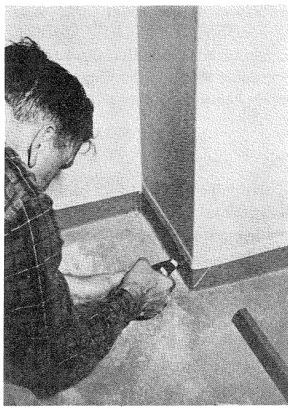
Fig. 5. En tokomponent fugemasse påføres en hjørnesamling med en almindelig »konditorsprøjte« af kraftigt papir.
